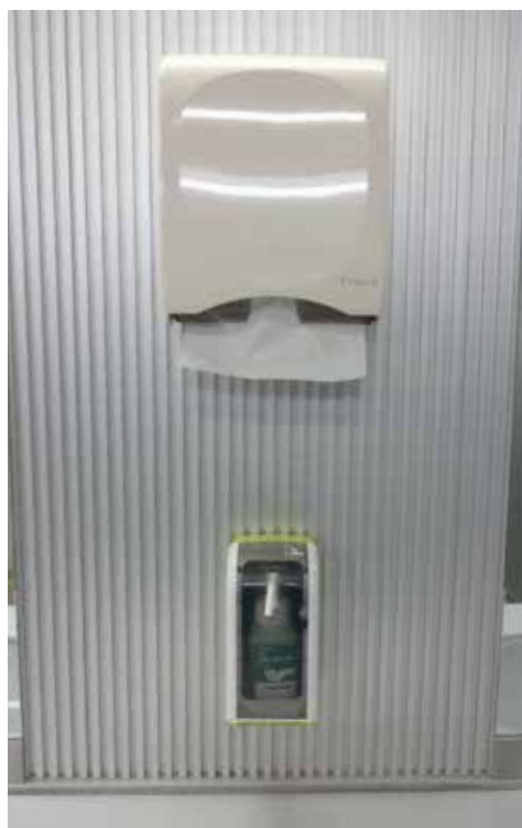
トイレ内にペーパータオル及び消毒液設置
