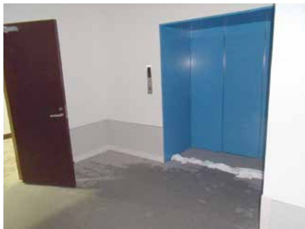
4階通路への漏水
