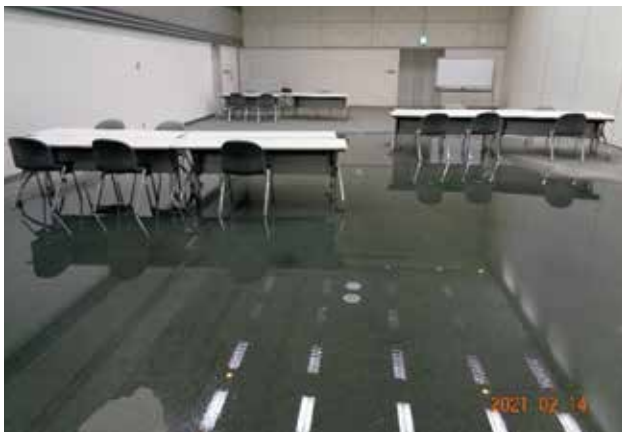
中会議室への漏水
