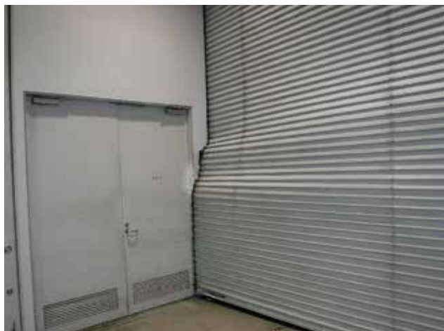
多目的展示ホール搬入口シャッターの破損
